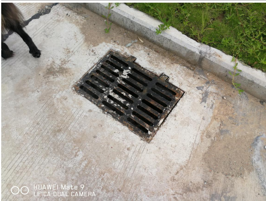
照片3 道路路边雨水篦现状
