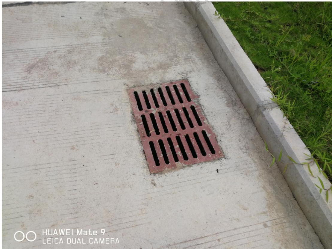
照片4 道路路边雨水篦现状
